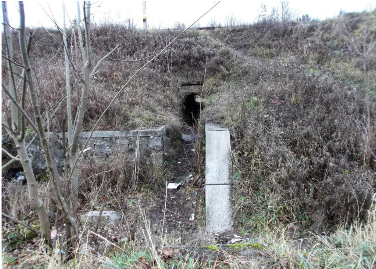
Fot. nr 21 . Komora zbiorcza przed zbiornikiem nadmiarowym . Komora zbierała wody z obydwu stron toru kolejowego i wychwytywała gałęzie i kamienie .
